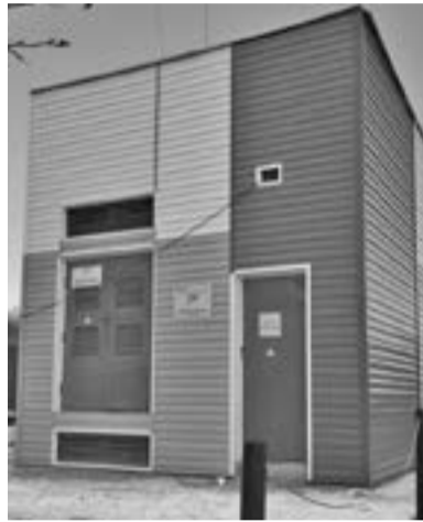
Вот так выглядят подстанции после проведенной «Региональными энергетическими системами» реконструкции.
